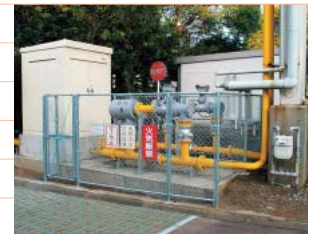
天然ガス供給システム
